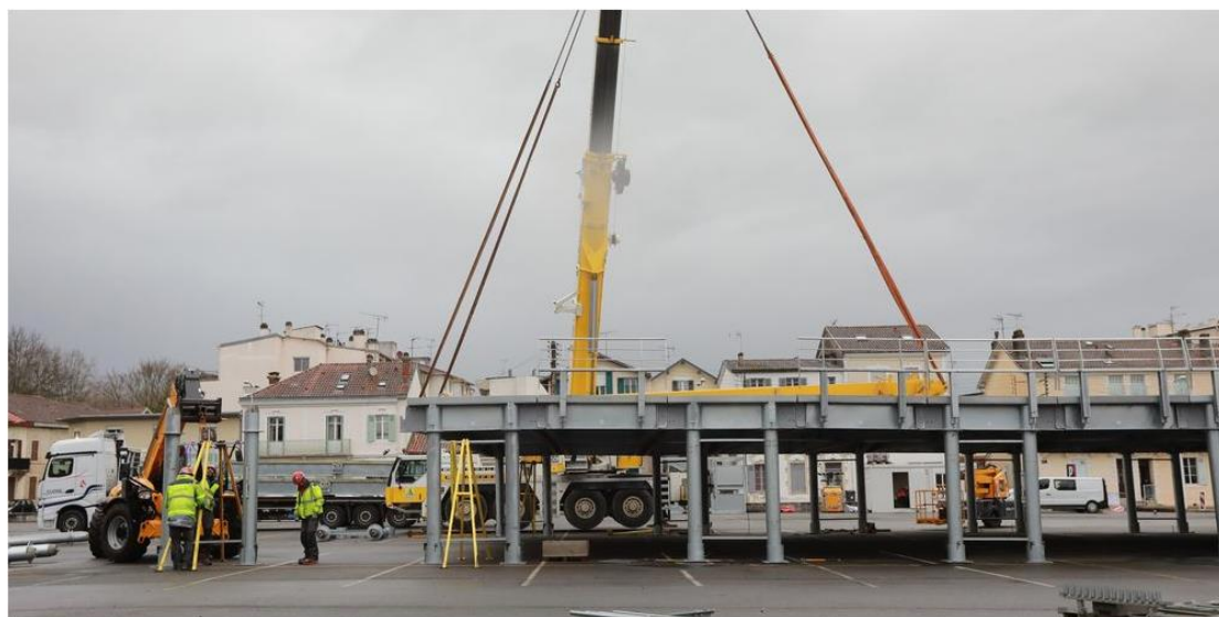
📷 L'avancée des travaux au parking Chanzy. © Crédit photo : Isabelle Louvier / "Sud Ouest"
